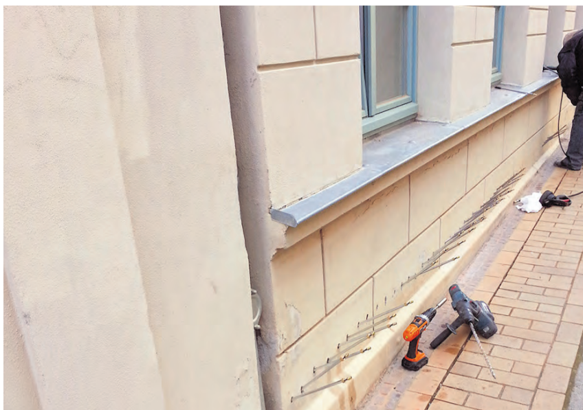
Das sieht nach viel Arbeit aus und ist es auch. Aber eine feuchte Wand ist nicht nur stetes Mahnmal von Baupfusch, sondern auch gefährlich.
